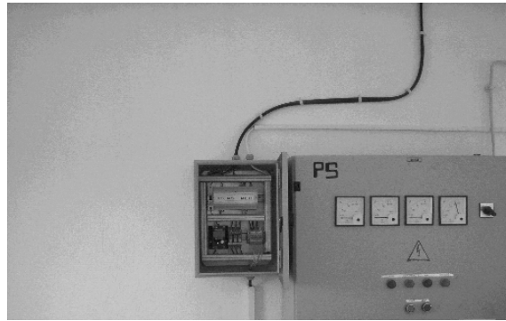
Şekil 10. Dalgıç pompa kontrol PIC PLC
